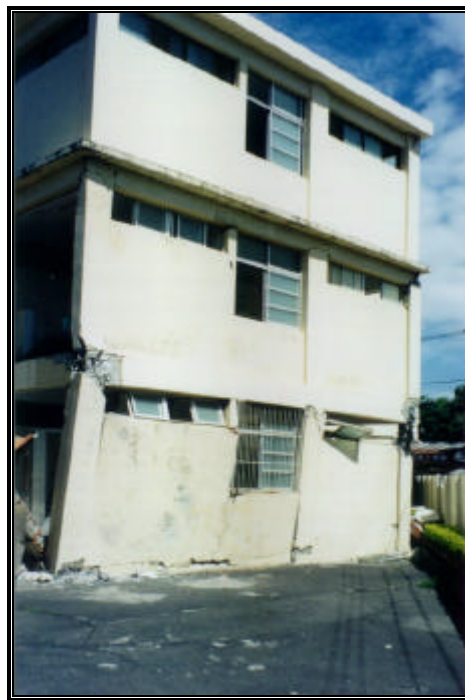
相片 2-21 南投縣埔里鎮南光國小【*】 說 明 高窗短柱剪壞情形
