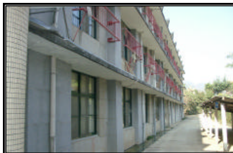
相片 2-10.2 南投縣國姓鄉北山國中 說明 東棟校舍，因為有設置翼 牆，故於地震後損害輕微
