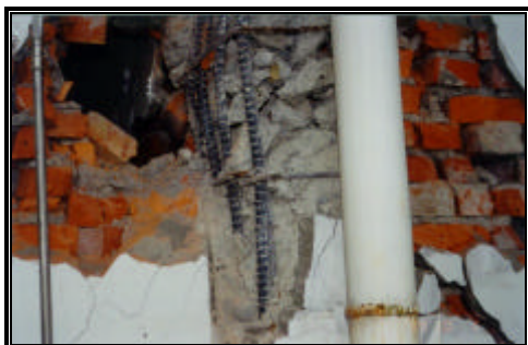
相片 2-5.3 南投縣竹山鎮竹山國小【*】 說明 箍筋彎勾長度、角度不足， 柱心混凝土碎裂
