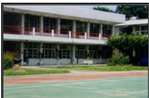
相片 2-5.1 南投縣竹山鎮竹山國小【*】 說明 正面無廊柱，柱被嚴重剪壞
