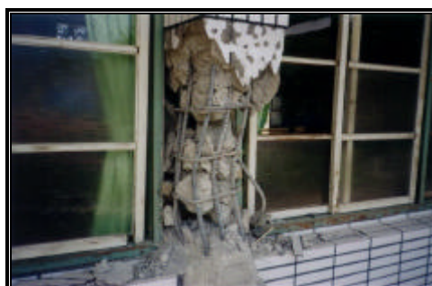
相片 2-5.2 南投縣竹山鎮竹山國小【*】 說明 窗台柱嚴重遭到剪壞
