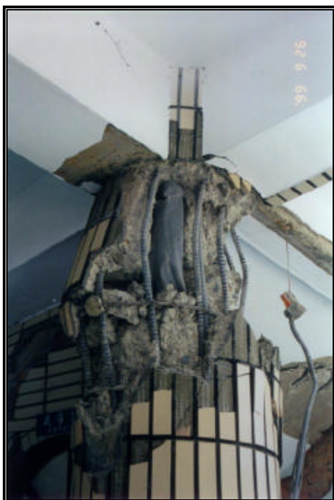
相片 5-1 南投縣埔里鎮南光國小【*】 說 明 柱頂部發生嚴重破壞，柱頭 爆開，鋼筋嚴重外露
