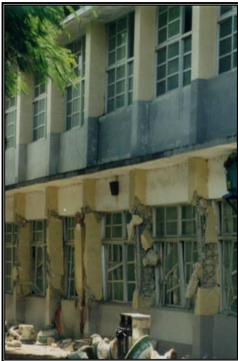
相片 2-20 南投縣埔里鎮南光國小【*】 說 明 窗台柱遭受嚴重破壞情形
