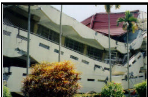
相片 2-17 南投縣埔里鎮南光國小【*】 說明 F 棟校舍於 921 地震後，整 棟崩塌
