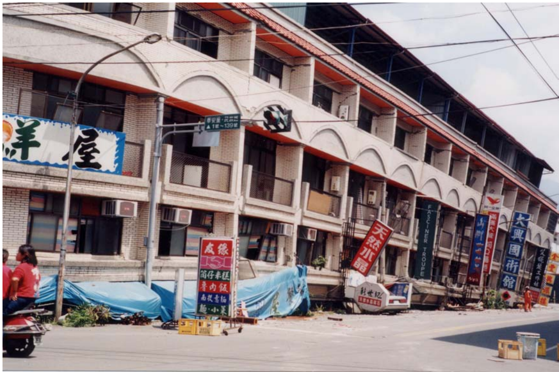
照片 2-5 一樓整層壓潰之沿街店鋪住宅（三）
