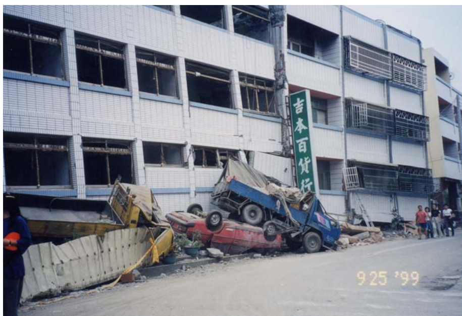
照片 2-3 一樓整層壓潰之沿街店鋪住宅（一）
