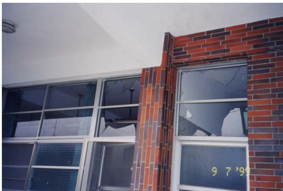
照片 2-11 玻窗破壞情形
