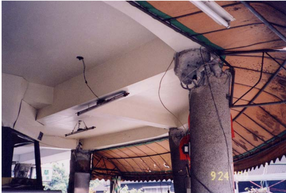
照片 2-2 一樓柱頭撓曲破壞
