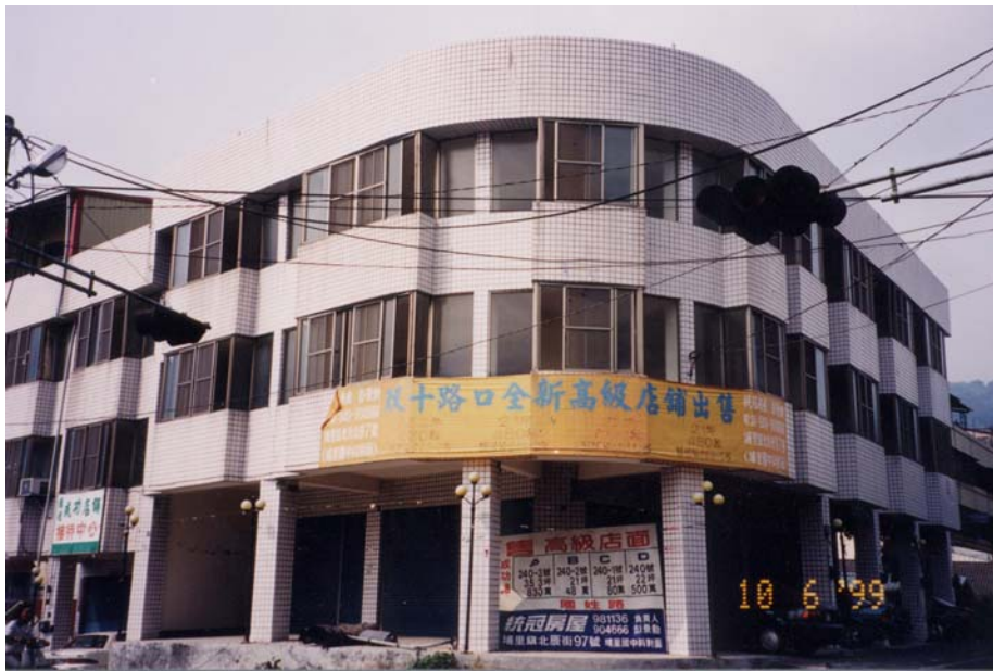
照片 2-10 二方向皆有牆壁之沿街店鋪住宅，受害輕微
