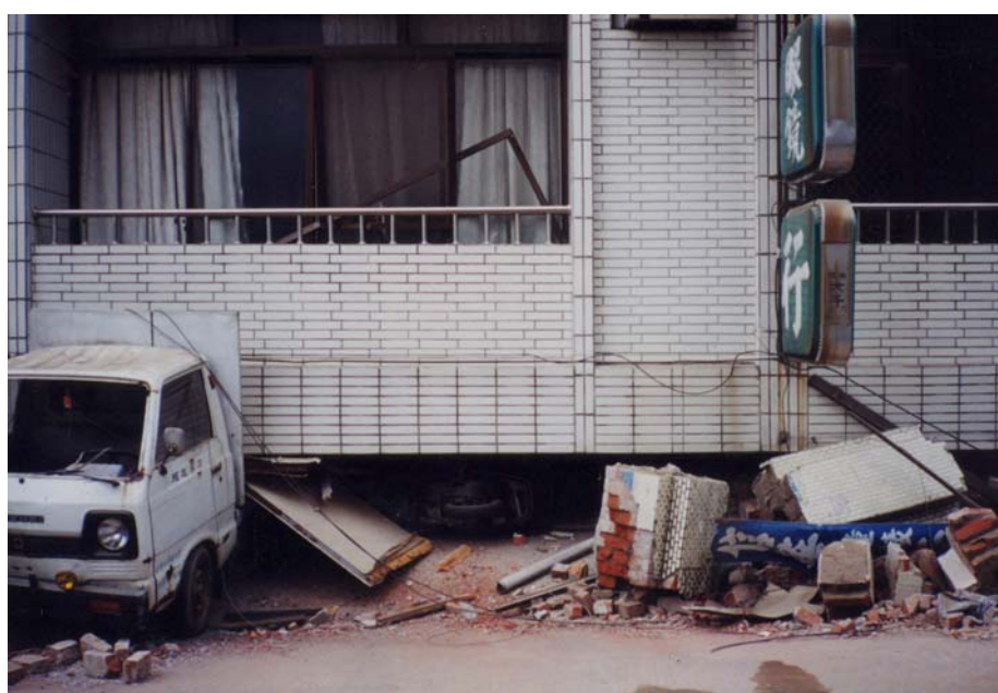
照片 2-4 一樓整層壓潰之沿街店鋪住宅（二）
