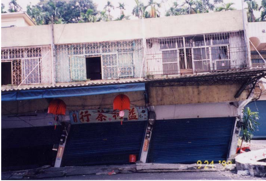
照片 2-1 一樓柱頭、柱底撓曲破壞
