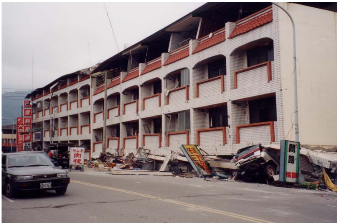
照片 2-6 一樓整層壓潰之沿街店鋪住宅（四）
