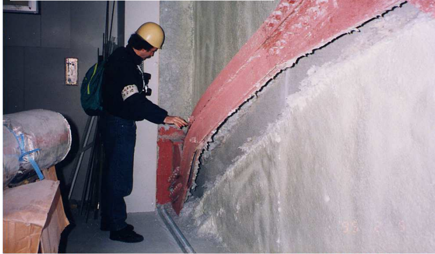
面外挫屈破壞
