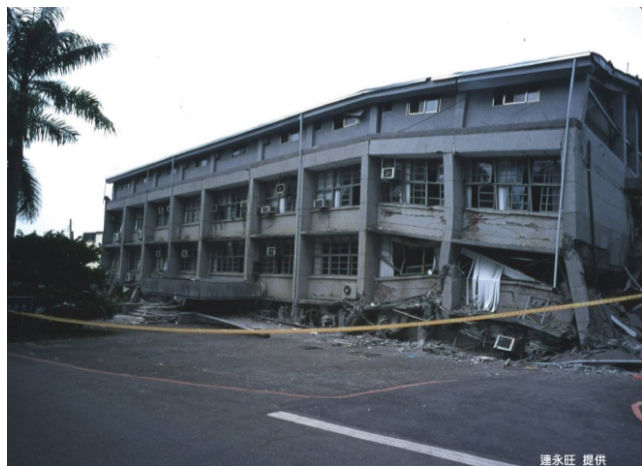
許多建築頂樓加蓋、一樓壁量不足，形成軟弱底層，以致921集集地震時，一樓完全崩塌而無存活空間／照片來源：內政部營建署雪霸國家公園管理處 俞錚峰 攝
