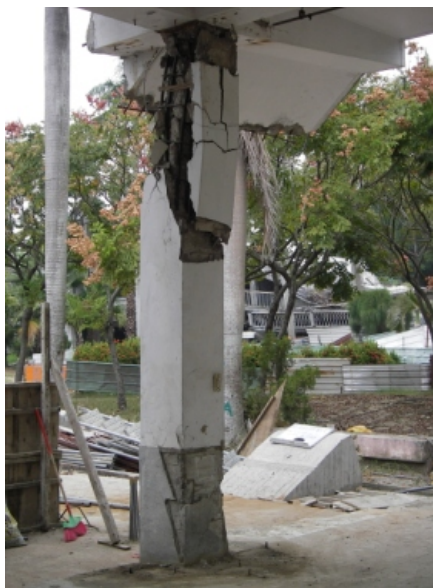
地震震損教室，須進行修復補強工程
