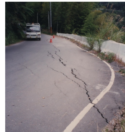
道路龜裂（道路右側為山谷）
