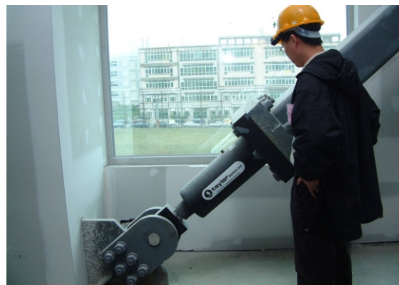
裝置在大樓裡的油壓 阻尼器
