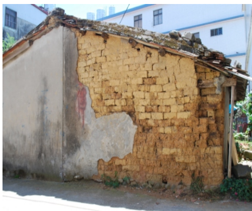
土角厝，部分石灰牆面裝飾已經剝落
