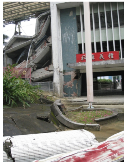
斷層切穿過霧峰光復國中校門口，川堂及花臺地表隆起，川堂兩側的校舍坍塌。
