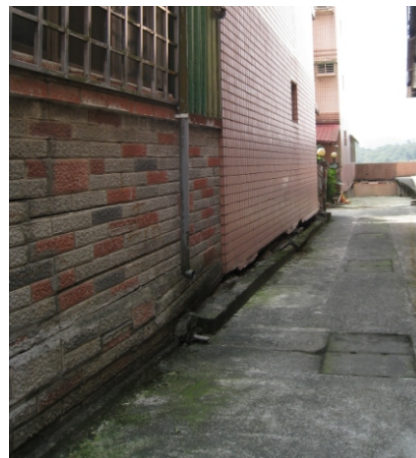
房屋地基龜裂
