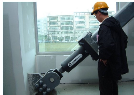
裝置在大樓裡的油壓 阻尼器
