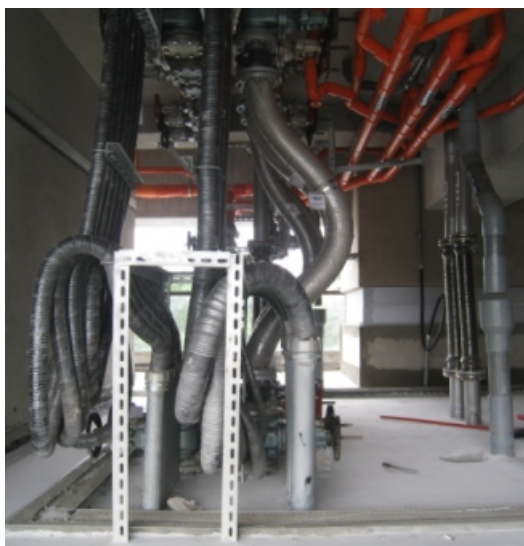
隔震層管線配置外觀
