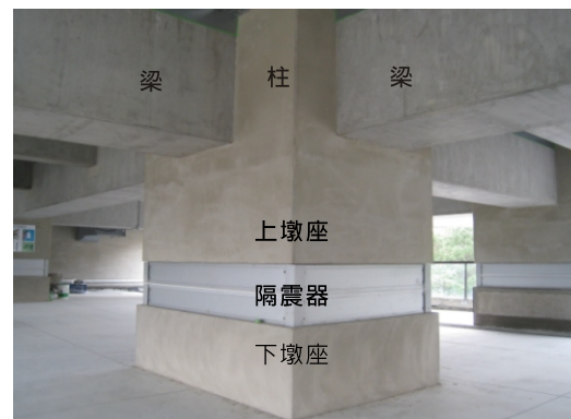
隔震器四周加裝隔板以防火害，並阻絕陽光中的紫外線，避免橡膠過早老化
