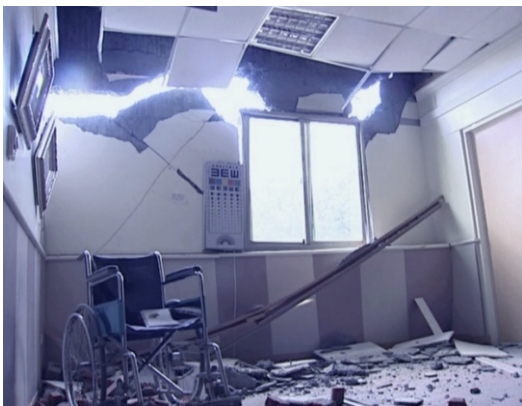
921集集地震，南投縣竹山鎮秀傳醫院內，震損一隅
