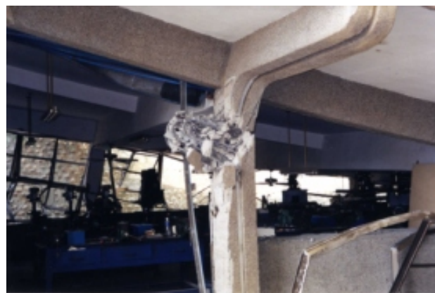
柱子變形過大而破壞，房子跟著倒塌
