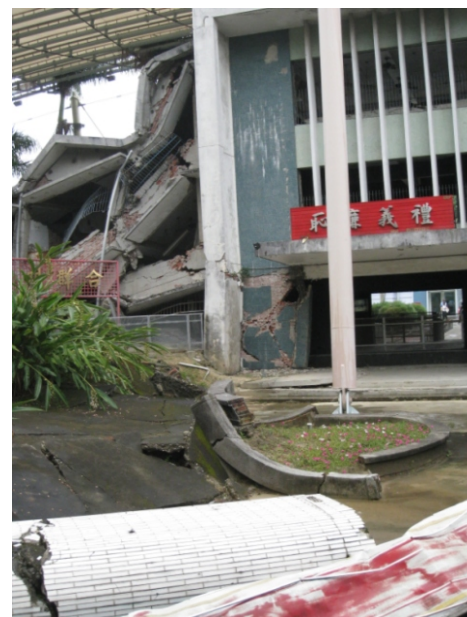
斷層切穿過霧峰光復國中校門口，川堂及花臺地表隆起，川堂兩側的校舍坍塌。
