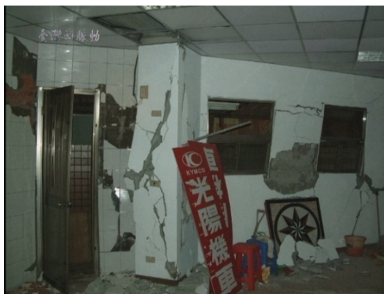
2000年331地震中，臺北縣土城市一棟樓房，柱子呈現扭轉破壞
