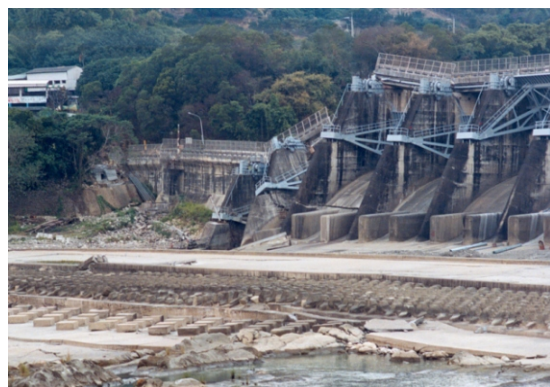
車籠埔斷層穿切石岡水壩
