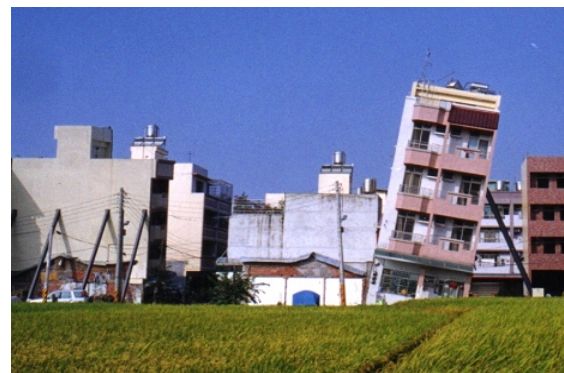
臺中縣霧峰鄉民宅傾斜
