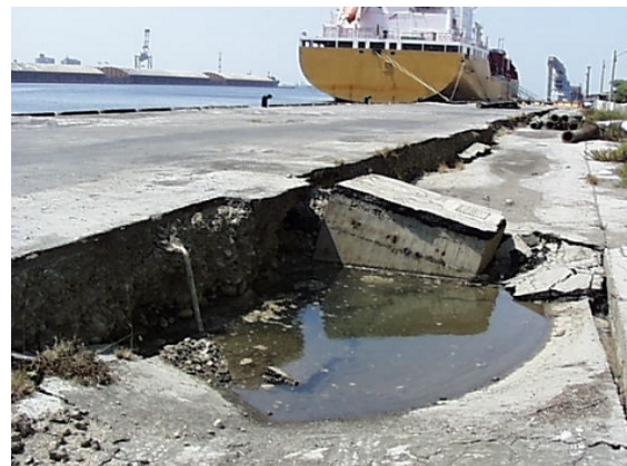
臺中港碼頭護岸地盤沉陷，原本水平的碼頭出現高低落差
