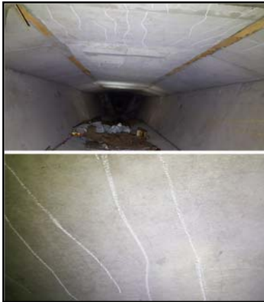
圖一 箱梁內部頂板有微小縱向裂紋
