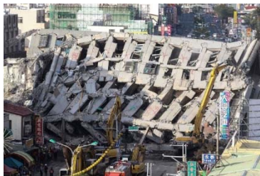
(b) 住商混合大樓倒塌後照片
