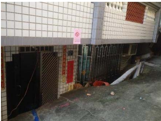
圖一 美濃地震後台南市安南區一處建物沉陷情況
