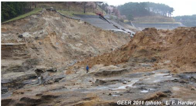
圖一 日本藤沼大壩主壩潰堤狀態(GEER 2011)
