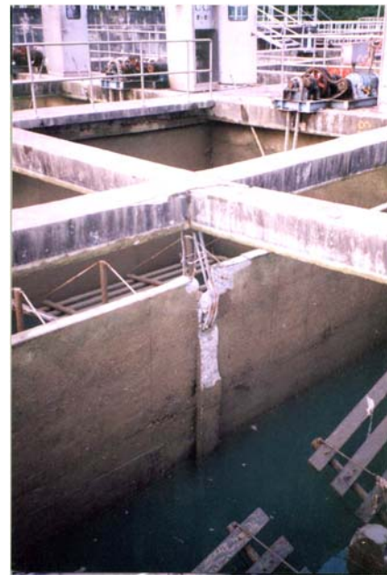
圖一 豐原第一淨水場膠羽池之震害 (台灣自來水公司第四區管理處提供)
