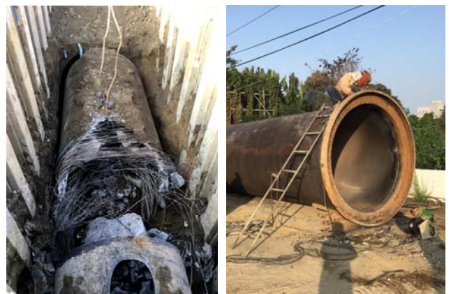
圖四 永康區開運橋西側送水管損壞處拆除與置換情形
