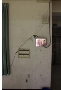
(d) 柱與磚翼牆斜向裂縫
