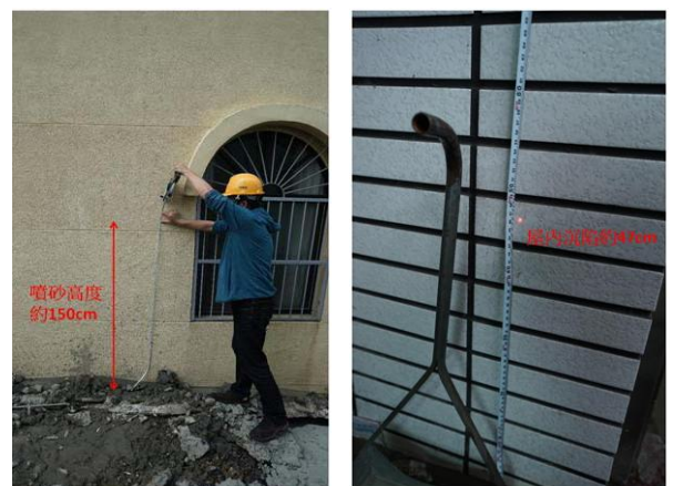
(B) 液化噴砂高度約 150 公分 (C) 一樓地板沉陷約 47 公分
