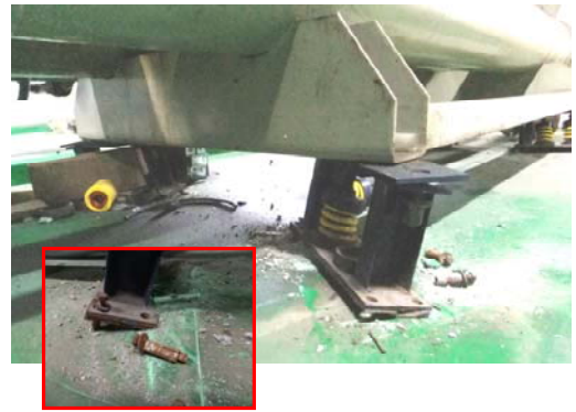
圖二 位於頂層之冰水主機彈簧隔振墊破壞
