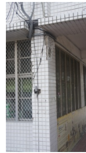
(a) 光華樓柱剪力破壞
