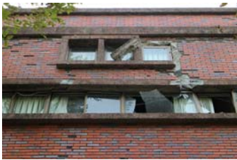
(a) 外側磁磚掉落，窗戶受損
