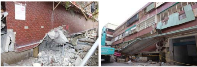
圖一 大智里菜市場受震倒塌照片
