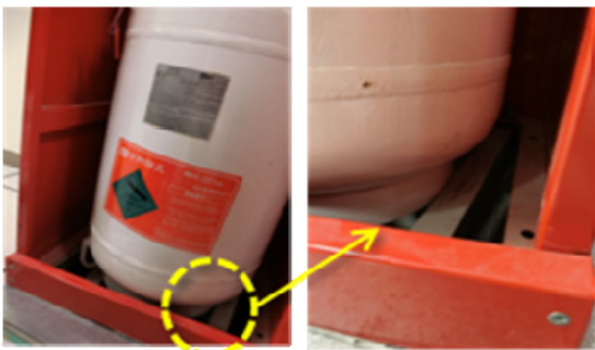
圖一 位於頂層機房之自動滅火系統鋼瓶位移
