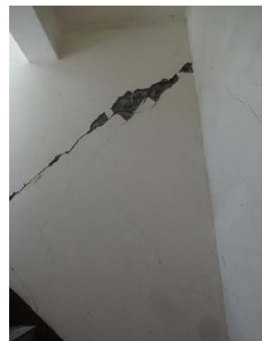
(b) 梯間牆剪力破壞
