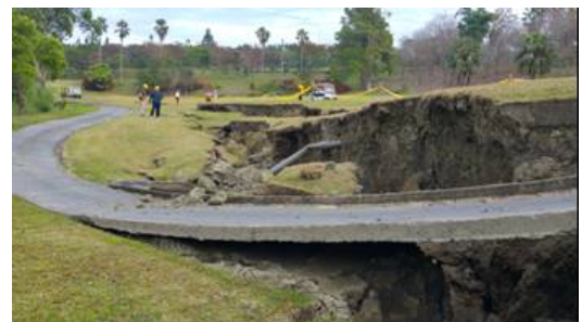
(B) 由道路斷裂處往東北向拍攝之裂縫景象
