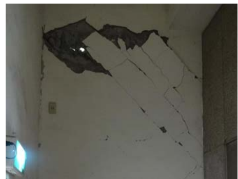
(a) 非結構牆之剪力破壞
