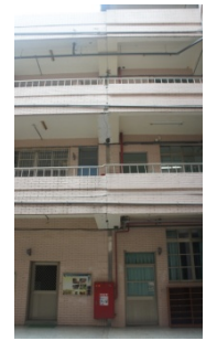
(b) 格致樓伸縮縫破壞
