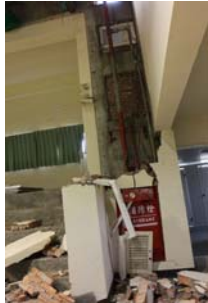
(c) 管道間紅磚掉落
