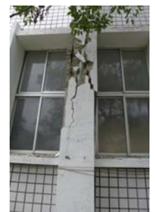
(b) 柱剪力破壞，可見柱內埋管
