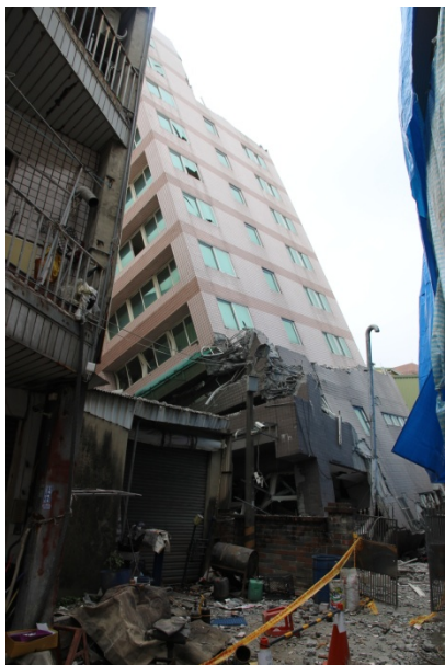
(a) 底層垂直桿件破壞
