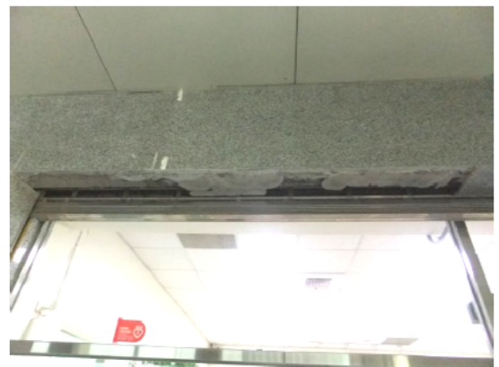
圖三(1) 濕式固定之室內石材飾面板破壞
