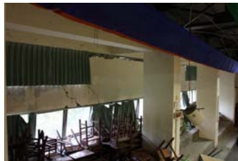
(b) 梁底下與磚牆交界面開裂
