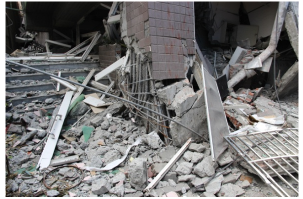
(b) 1 樓柱軸力破壞
