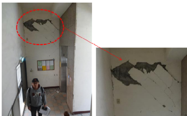
圖四 台南市 13 層 RC 住宅大樓非結構牆體破壞
