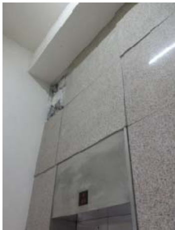
圖三 (2) 濕式固定之室內石材飾面板破壞
