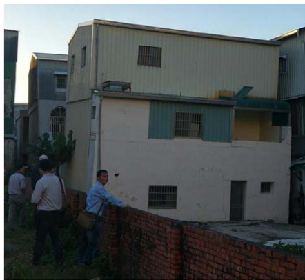
(A) 惠安街 161 巷 24 號建物下陷傾斜
