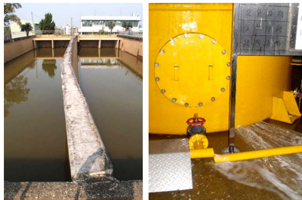
圖七 山上淨水場之舊沉澱池分隔牆開裂傾斜與四號次氯酸鈉儲藥桶底部破損洩漏
