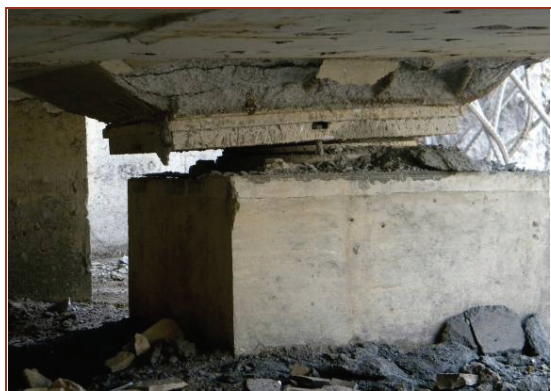
圖二 匝道橋台支撐位移及損壞
