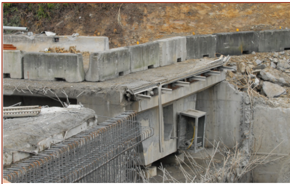
圖一 北向匝道背牆損壞
