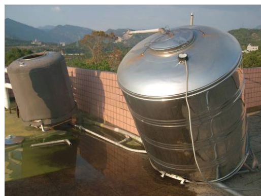
圖十六 學校水塔基腳破壞造成傾斜
