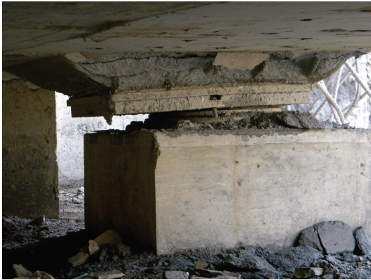
圖四 北向匝道橋台處支承位移及損壞
