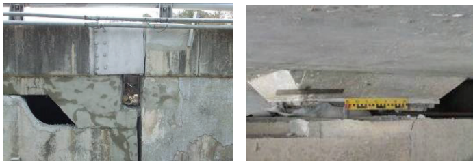
圖十 田寮三號橋北端橋面與橋台碰撞與盤式支承異常滑移
