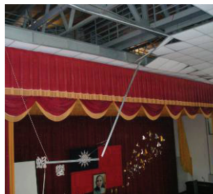
圖十二 學校禮堂輕鋼架天花板骨架與面板掉落
