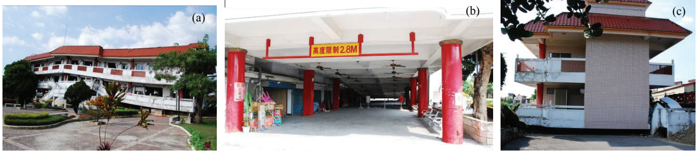
圖五 內門紫竹寺活動中心：(a) 建物整體受損狀況，(b) 一樓側視照，(c) 建物一樓倒塌狀況
