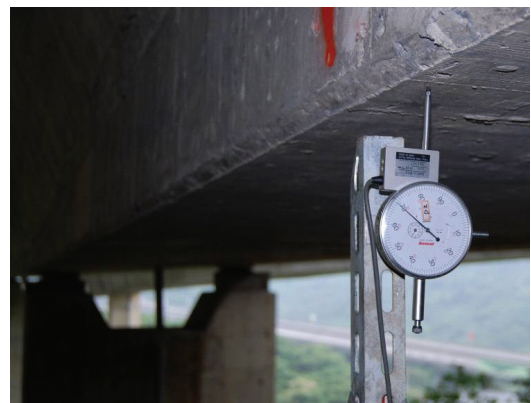
圖八 監測大梁變位之千分儀
