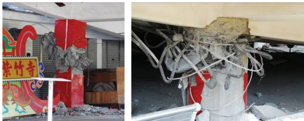
圖六 內門紫竹寺活動中心一樓柱構件壓碎破壞情形
