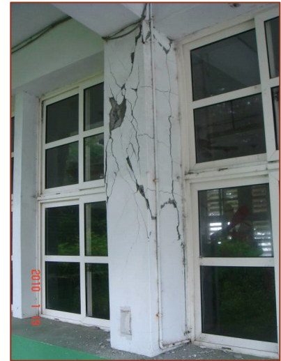
圖九 磯崎分校教學教室 B6 柱明顯剪力破壞，裂縫寬度達 8mm，並有局部混凝土塊剝落，柱主筋裸露
