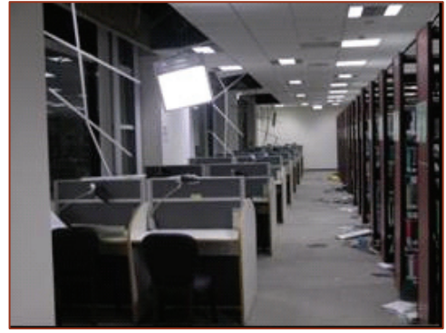
圖五 東華大學圖書館輕鋼架天花板破壞
