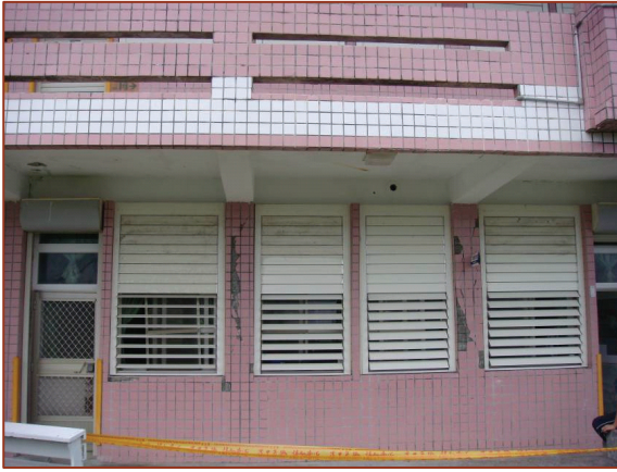
圖十二 台東三間國小教學行政大樓窗台柱 3、4 一樓室外實際裂縫開裂情形
