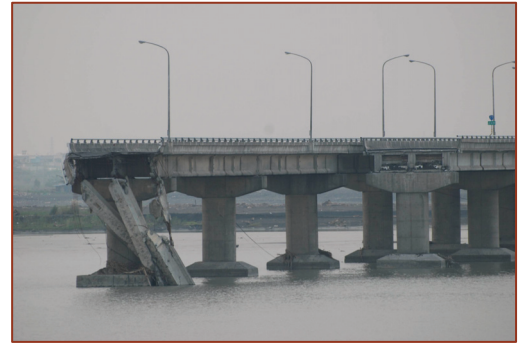
圖四 雙園大橋損壞情形(洪曉慧拍)
