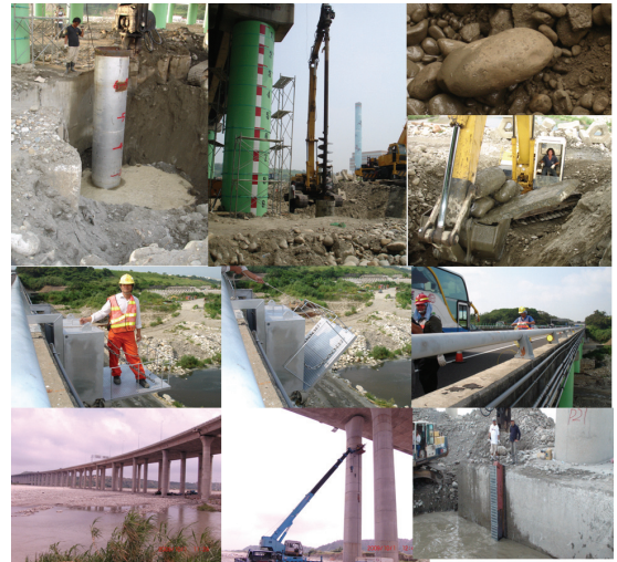
圖二 大甲溪國道一號及三號高速公路橋墩基礎監測系統安裝
