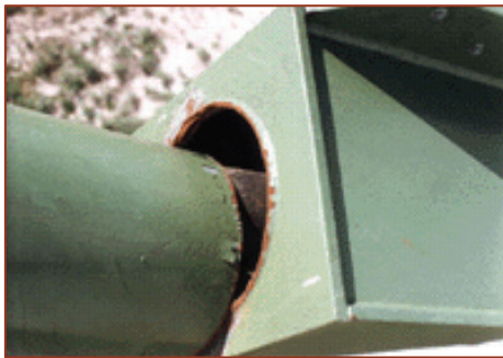
圖二 斜張橋導管破壞（國外橋梁案例）
