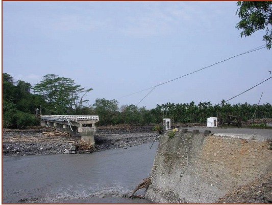
圖二 口社橋損壞情形(盧智宏拍)
