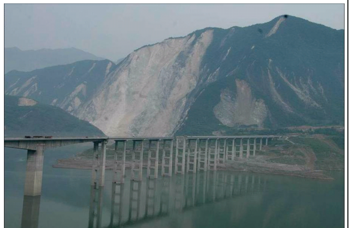
圖十六 成汶高速公路橫跨岷江之大橋(施工中)震損情形，沿岸山崩情況極為嚴重
