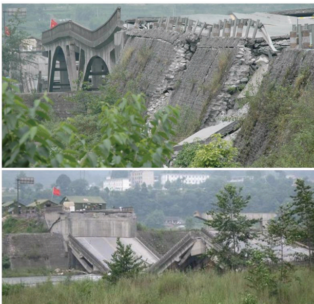
圖十三 彭州小魚洞大橋之破壞情形
