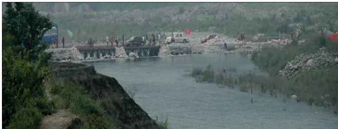
圖十二 小魚洞大橋鄰近已搭設便橋供人車通行
