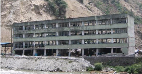
圖二十四 自橋頭向對岸映秀鎮內望去之三層樓以上危樓
