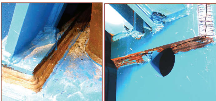
圖四 兩端支承夾具焊道破裂
