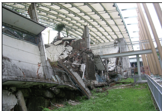
圖二十 北棟倒塌教室原址保存
