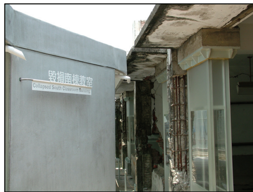
圖二十二 毀損教室震損柱子（透明壓克力補強支撐）
