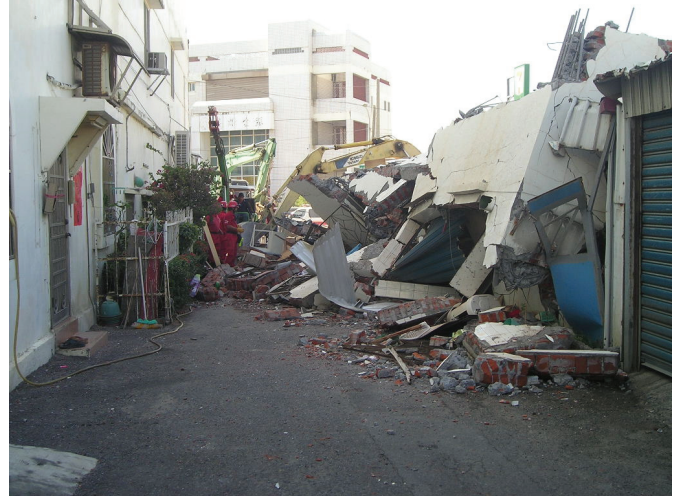
圖四 正興傢俱行震後倒塌側邊狀況
