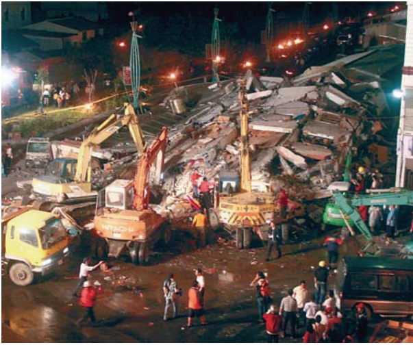
圖三 正興傢俱行震後倒塌頂視狀況
