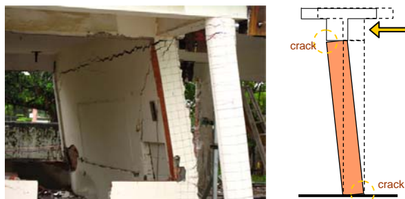
圖一 校舍現地試驗之隔間磚牆面外破壞模式
