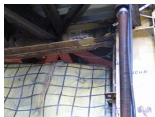
圖七 鋼板與梁柱構件分離
