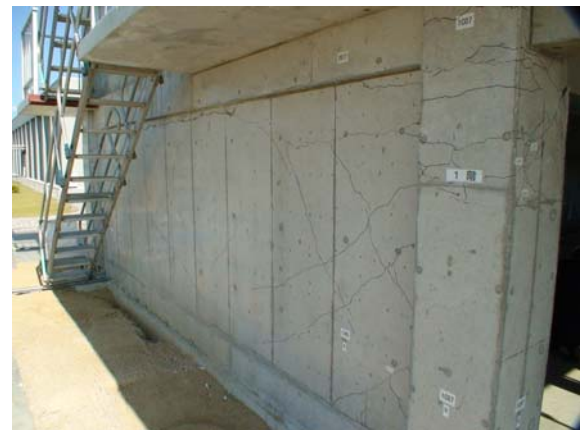
照片二 RC 空構架牆體與軟土基礎破壞狀態
