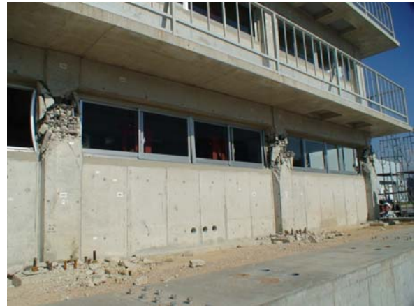
照片一 三層樓 RC 空構架振動台試驗後試體破壞狀態
