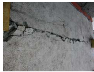
圖八 混凝土樓板破壞
