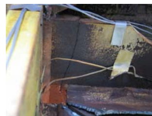
圖六 中間梁斷裂
