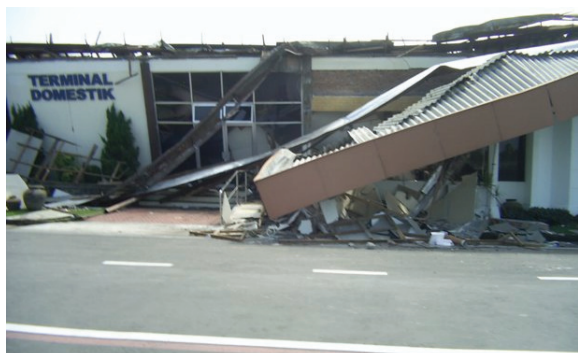
圖三十一 發生倒塌的日惹機場建築物
