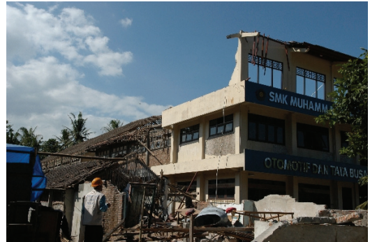
圖十三 SMK 建築屋頂層損毀情況
