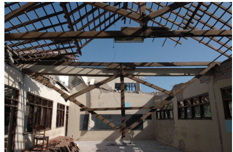
圖十四 SMK 建築屋架損毀情況
