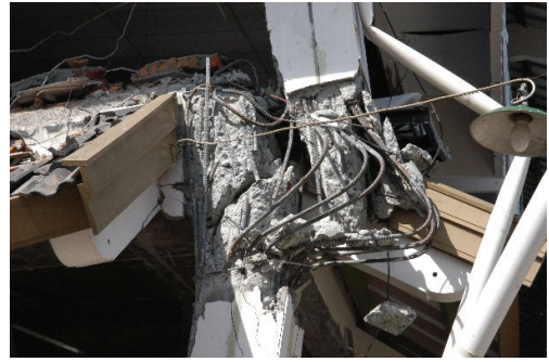
圖十二 BPKP ISI 柱桿件的破壞情況
