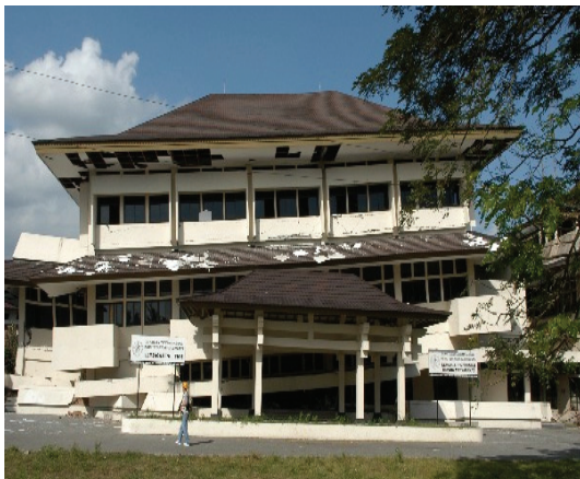
圖九 ISI 一棟嚴重受損之建築
