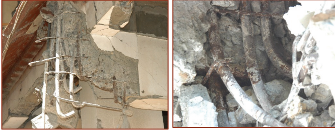
圖七 STIE 建築鋼筋細部 圖八 STIE 建築接頭附近混凝土蜂巢
