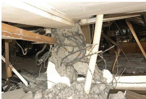
圖十 ISI 柱桿件的破壞情況
