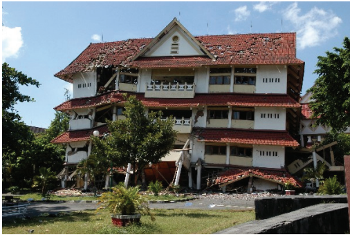
圖六 STIE 建築受損情況-2
