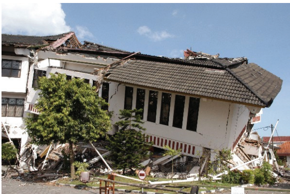
圖十一 BPKP 建築倒塌情況
