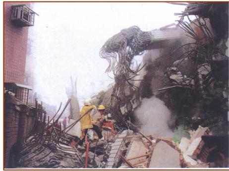
圖一 921 集集地震大樓地震震害害解說(新莊博士的家)
