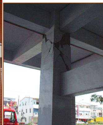
照片四 一樓夾層處，形成短柱效應
