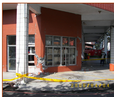
照片一 轉角柱因造型需求，配筋不對稱易造成破壞
