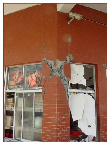
照片三 上部翼牆束制，導致柱有效長度明顯低於其他挑高柱，因此承擔剪力需求較大，且屬典型非韌性配筋，故造成剪力破壞
