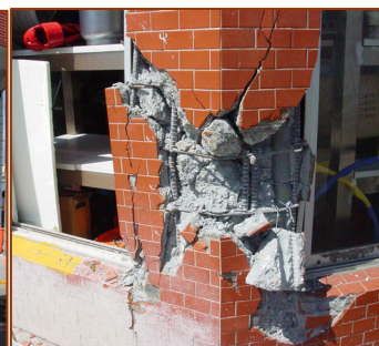
照片二 #3 箍筋間距 20 cm，90 度彎勾，主筋搭接 90 cm，內埋水管，典型非韌性配筋，圖束箍筋不足，造成剪力破壞
