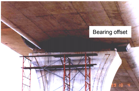
圖一 國道 4 號中二高台中環線豐原高架橋樑支承錯位破壞情形 (921 地震)
