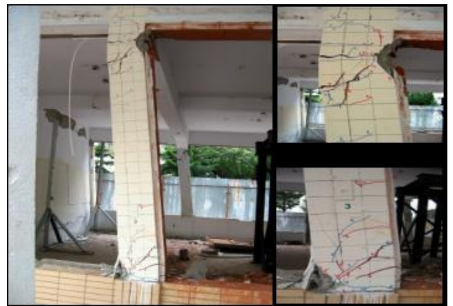
圖六 B3 柱試驗後之撓剪破壞情況
