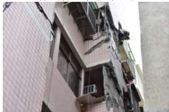
(h)外牆破壞(側面)
