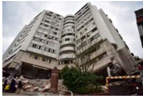
(b)倒塌背面
