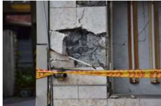
(b)一樓角柱破壞
