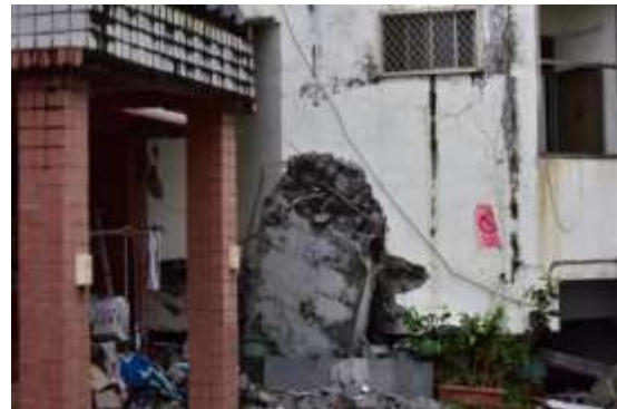
(f)一樓柱破壞(背面)
