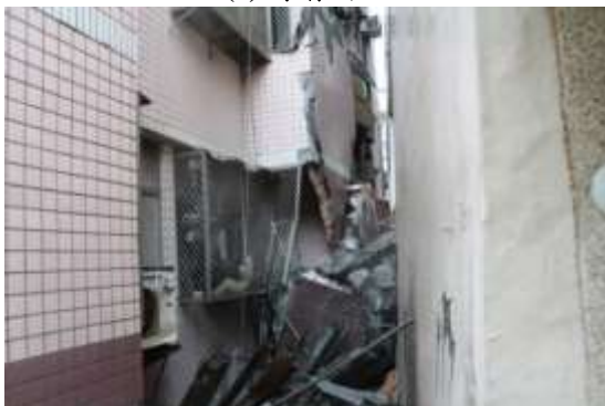
(g)外牆破壞(側面)
