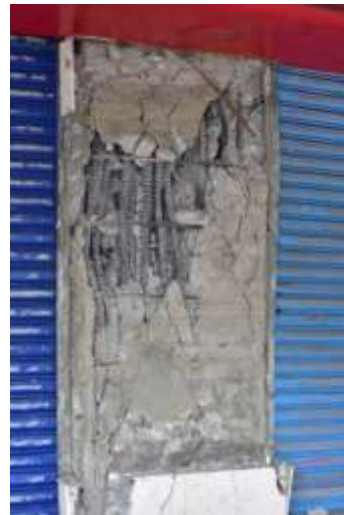
(d)一樓柱剪力破壞
